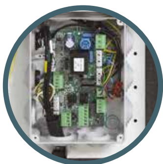
Particolare del Quadro elettrico Detail of the Electric box
